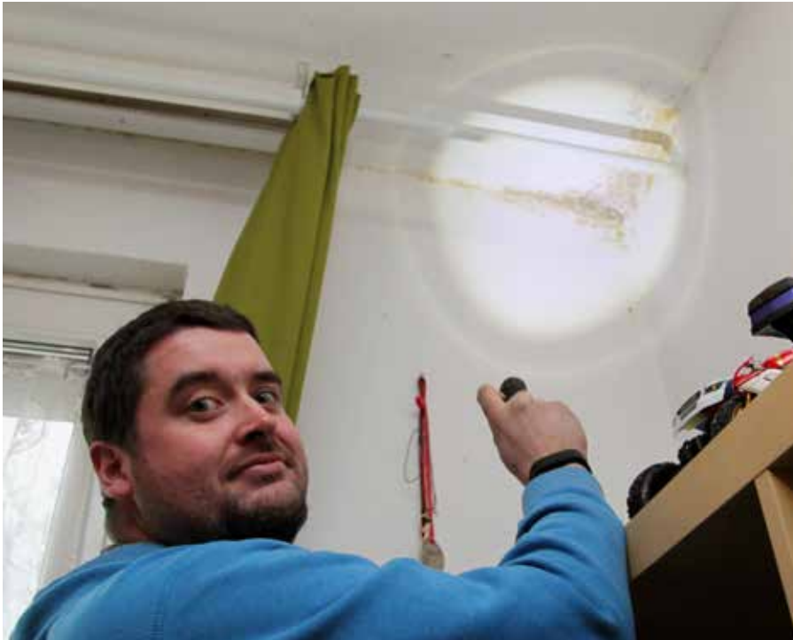
Inspektion des Kinderzimmers mit Taschenlampe: Die Gesundheitsrisiken durch Schimmel sind hinlänglich bekannt und verunsichern Marko Wolf und seine Frau enorm.
